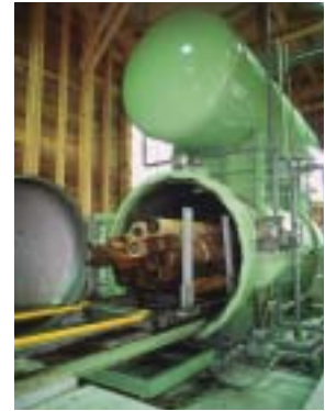
(写真3-12) 防虫防腐施設AAC
